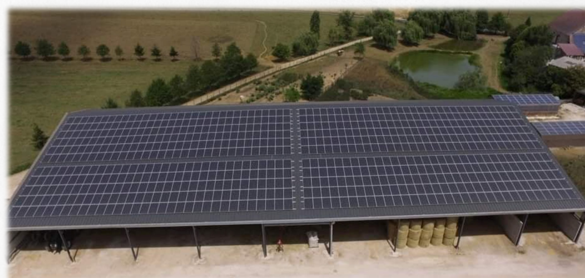
Installation photovoltaïque en autoconsommation _ GAEC De La Ferme Bio De They
