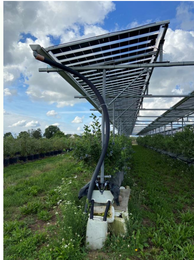
Gouttières de récupération d'eau (Myrtilles, Broekhuizen Hol)
