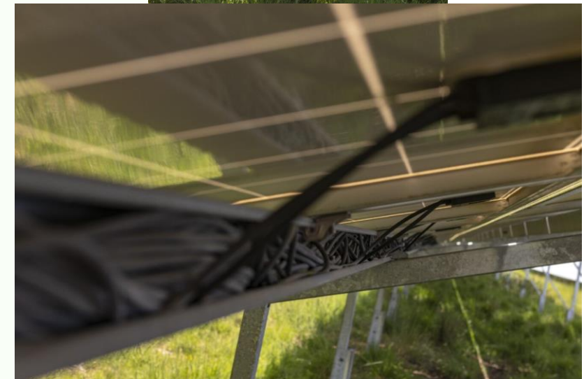
Gouttière à câbles électriques (Lacs Médocains, Fr)
