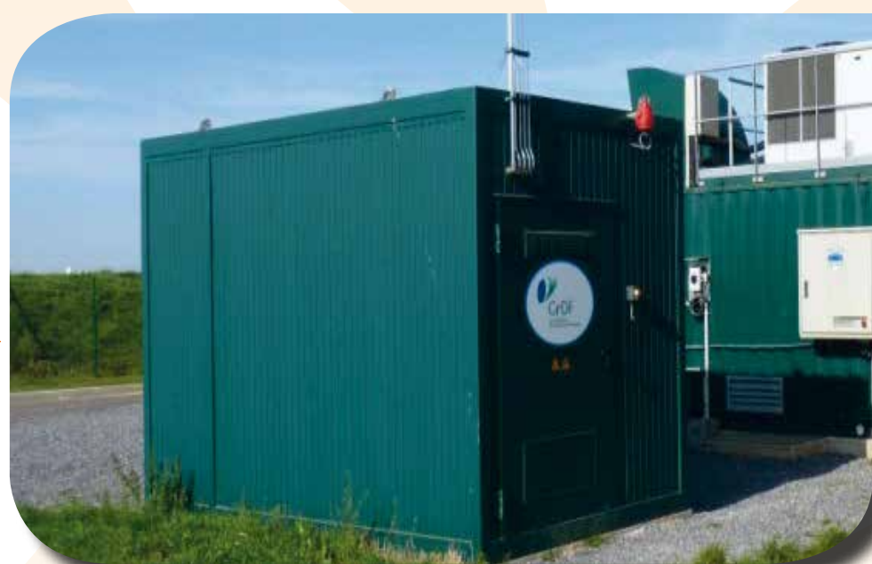
Poste d'injection : Odorisation, Contrôle, Comptage
