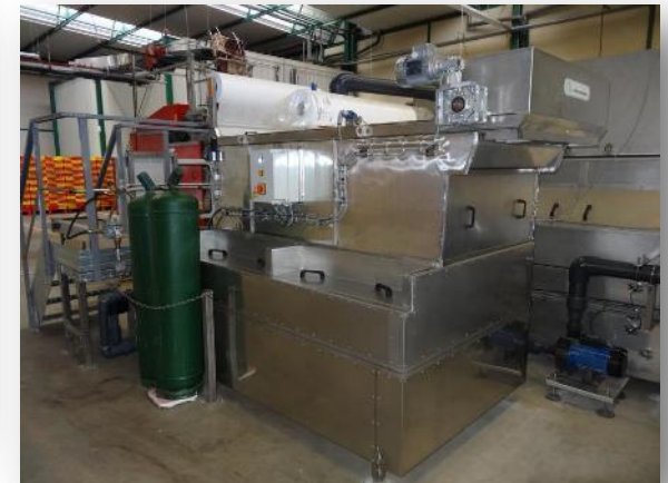
Bac de chauffage et de recyclage de l'eau
