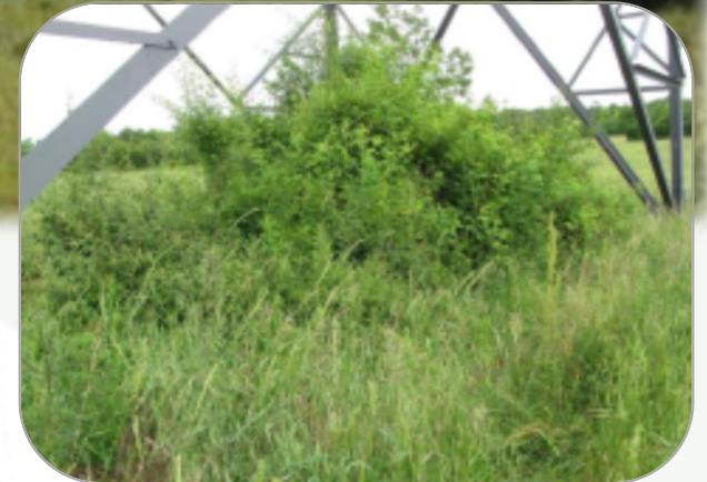
Pieds de pylônes
